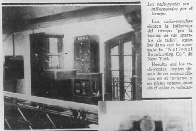
Vista de uno de los tableros de amplificación "Philips", que es el mayor del mundo, instalados en el Capitolio por la importante firma holandesa.
